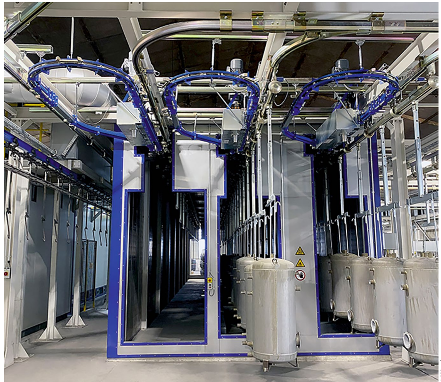
Die Fördertechnik ermöglicht einen zuverlässigen Trocknerbetrieb.
